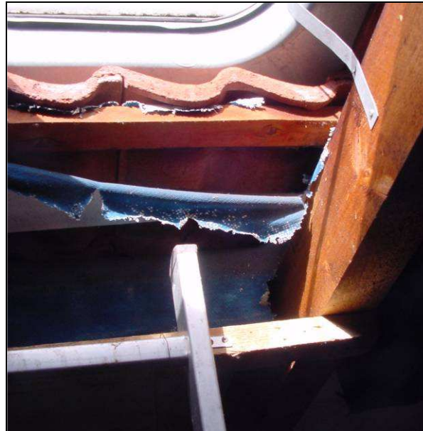
Abb. 4: Schäden am Übergang zur Dachluke
