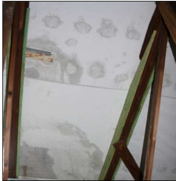
Abb. 8: Wasserdurchtritte durch die Unterspannbahn entlang der Fugen der Eindeckungselemente
