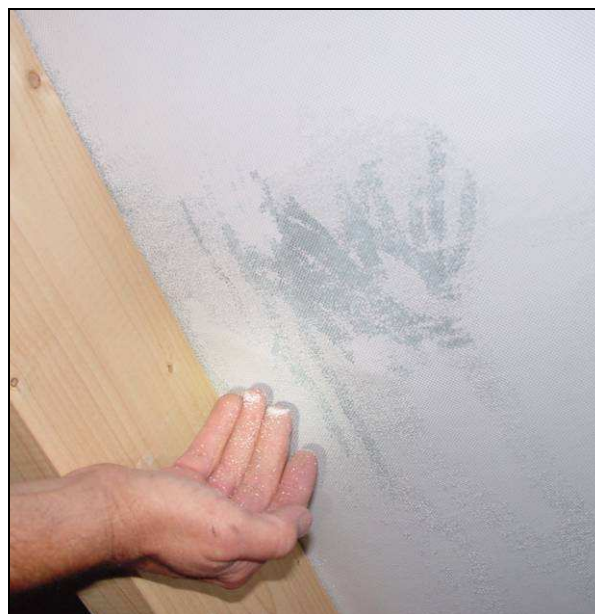
Abb. 6: Abkreiden der unteren Beschichtung
