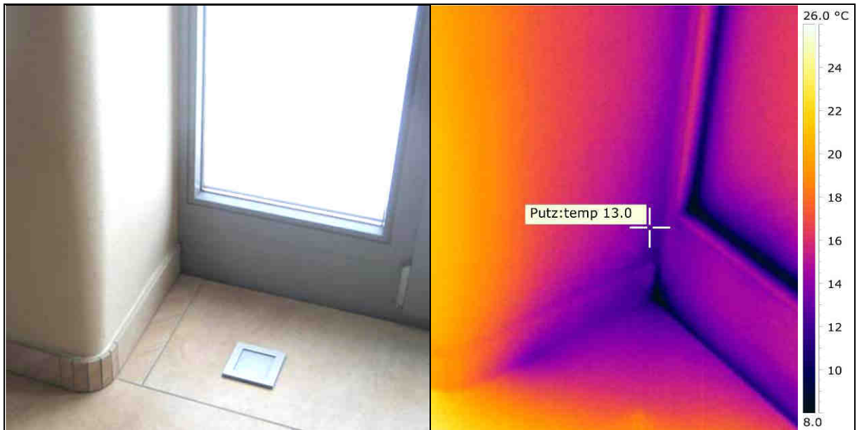
Abb. 29 + 30: Auswirkung von vor bodentiefen Fenstern verlegten Heizleitungen
