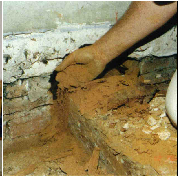
Abb. 72: Überprüfung des Zustandes der Balkenköpfe im Bereich der Auflager der Holzbalkendecke [Flohr 2009]
