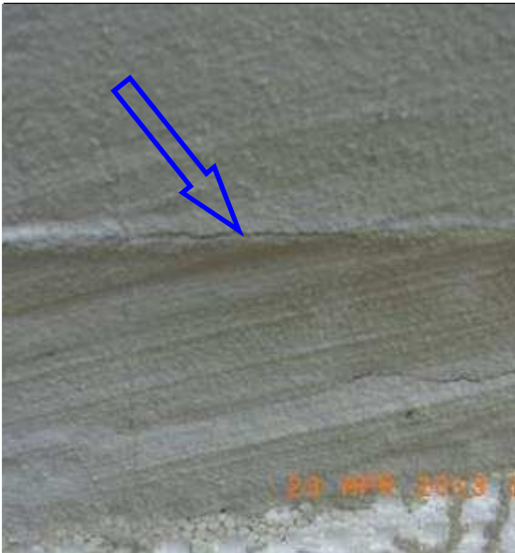
Abb. 19: Detailaufnahme mit Rissbildungen in der Abdichtung bei gleichzeitiger Aufwölbungen an den Rissflanken (Pfeil)
