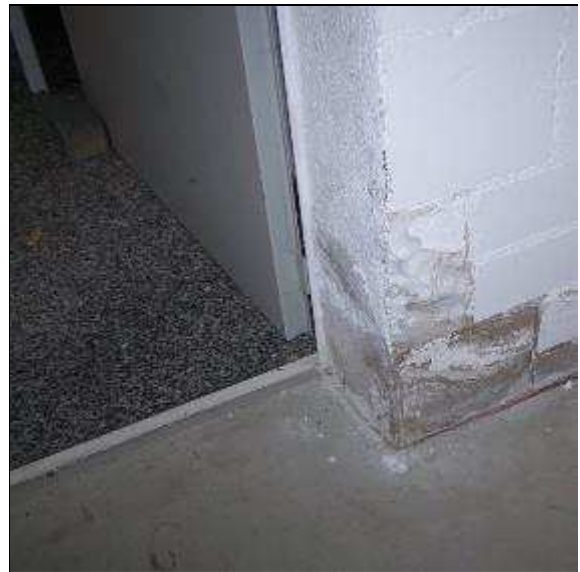
Abb. 48: Typisches Schadensfoto im Bereich der Kellerwände
