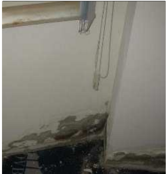
Abb. 20: Wasserschäden in der Sockelzone im Gebäudeinnern.
