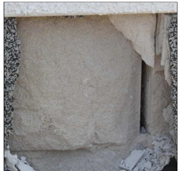
Abb. 14: Offene Stoßfuge des Porenbetonmauerwerks
