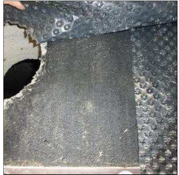
Abb. 24: Geringfügige Risse in der durch die Bahnenabdeckung vor Witterung geschützten KMB-Abdichtung
