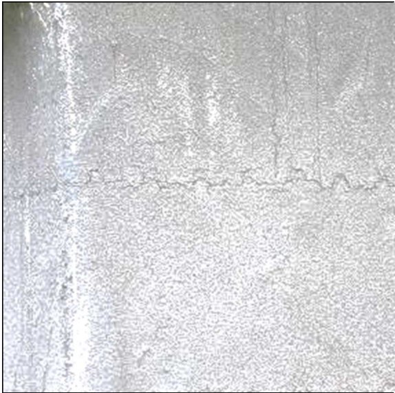
Abb. 23: Deutliche Risse in der nicht abgedeckten KMB-Abdichtung entlang der Fugen der Steine
