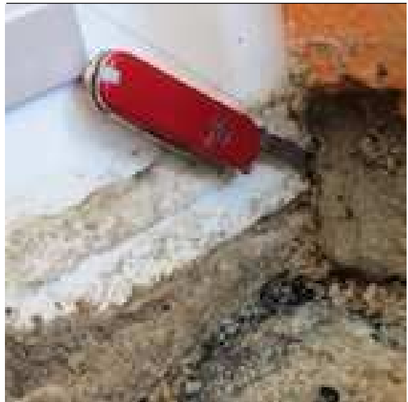
Abb. 32: An den Türschwellen und den aufgehenden Rahmenprofilen haftete die Abdichtung nicht an.
