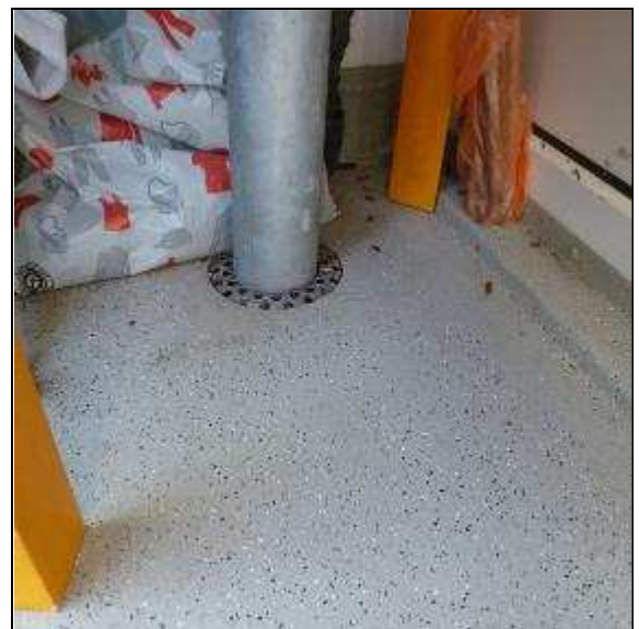
Abb. 80: Entwässerungssituation der unteren Geschosse
