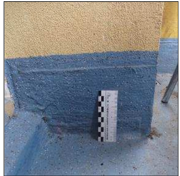
Abb. 82: Die Aufkantungshöhe der Beschichtung beträgt gut 15 cm
