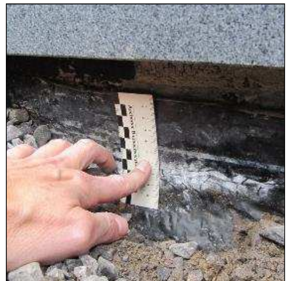
Abb. 76: Oben offener Abschluss der Bauwerksabdichtung unter der Haustürschwelle
