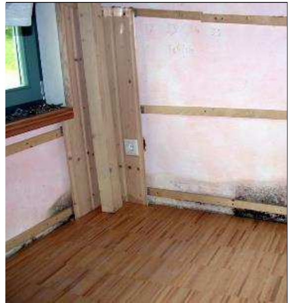
Abb. 38: Schimmelpilzbildung hinter der Holzbekleidung der Innen- und Außenwände
