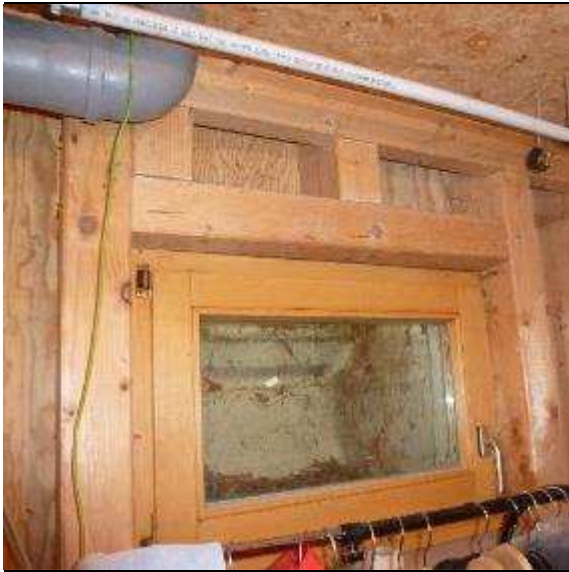
Abb. 57: Innenansicht des nicht ausgebauten und zu Lagerzwecken genutzten Kellers – keine Feuchtigkeitserscheinungen vorhanden
