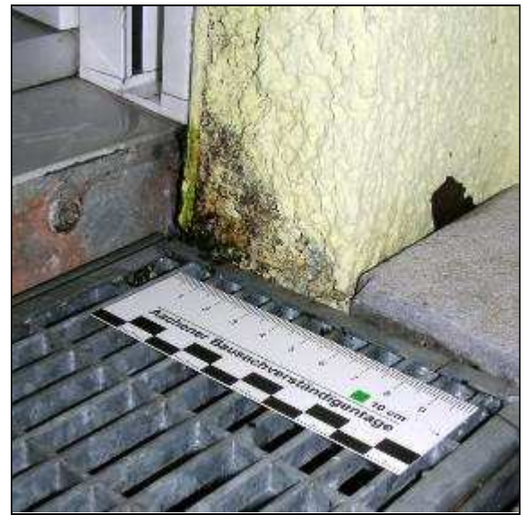
Abb. 46: Durchfeuchtungsschäden im Bereich der Türschwelle
