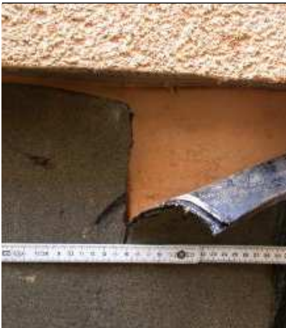
Abb. 35: Die Abdichtung haftet nicht auf dem Untergrund und war am oberen Rand nicht mechanisch fixiert. Sie wurde nur durch eine vorangestellte Platte mehr oder minder lose gehalten, die hier entfernt ist.
