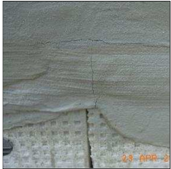
Abb. 18: Die Stoßfugen zeichnen sich als Rissbildungen ab.
