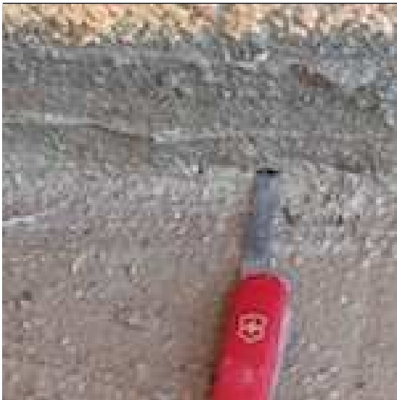
Abb. 31: Entlang des Boden-Wand-Anschlusses waren Lücken in der MDS-Abdichtung vorhanden, eine Hohlkehle fehlte, die Schichtdicke der Abdichtung ist wesentlich zu gering.
