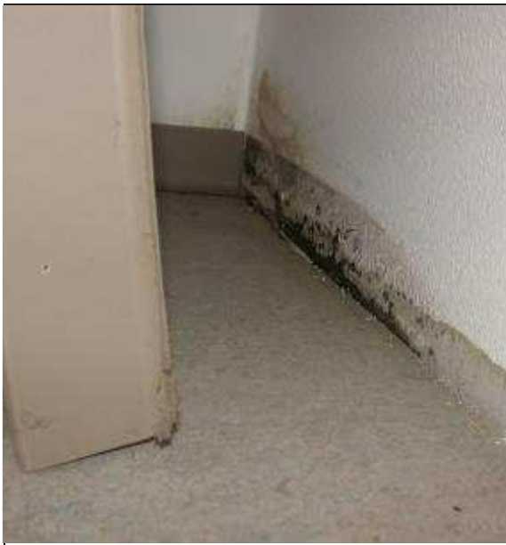
Abb. 37: Schimmelpilzbildung auf Wandoberflächen
