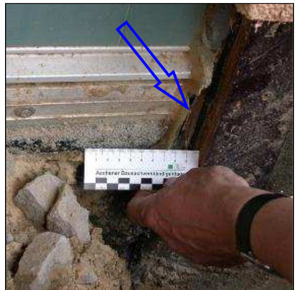
Abb. 34: Die Abdichtung wurde nur unterhalb der Türschwelle angeschlossen, die Fuge seitlich zwischen dem Türelement und der Abdichtung in der Sockelzone klafft offen auf.
