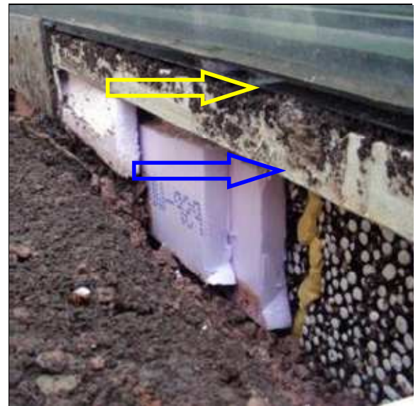
Abb. 40: Nach dem Entfernen der außenseitigen Platte: Die Abdichtung endet im Bereich des Fassadensockels auf der Unterseite der Fassadekonstruktion (blauer Pfeil) oberhalb der Oberkante des Geländes (gelber Pfeil)
