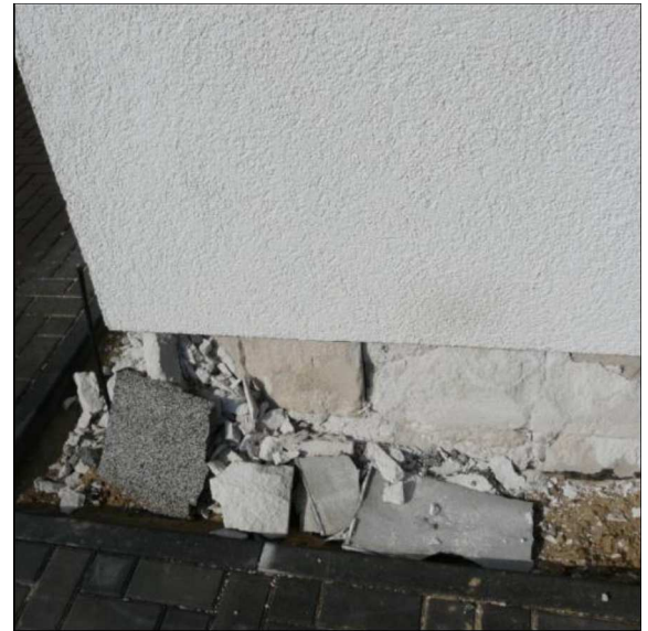
Abb. 12: Schollenförmige Abplatzungen im Sockelbereich
