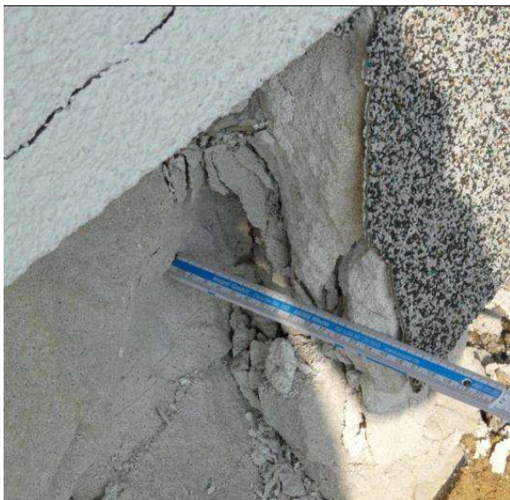
Abb. 13: Die Abplatzungstiefe des Mauerwerks beträgt bis zu 20 cm
