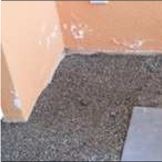
Abb. 29: Balkon mit Plattenbelag im Splittbett und Ausblühungen des Putzes in der Sockelzone
